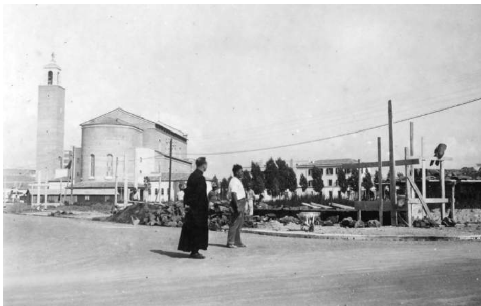
31. Don Armando Alessandrini osserva i lavori di costruzione del muro di cinta che delimita il complesso oratoriale (estate 1940)
