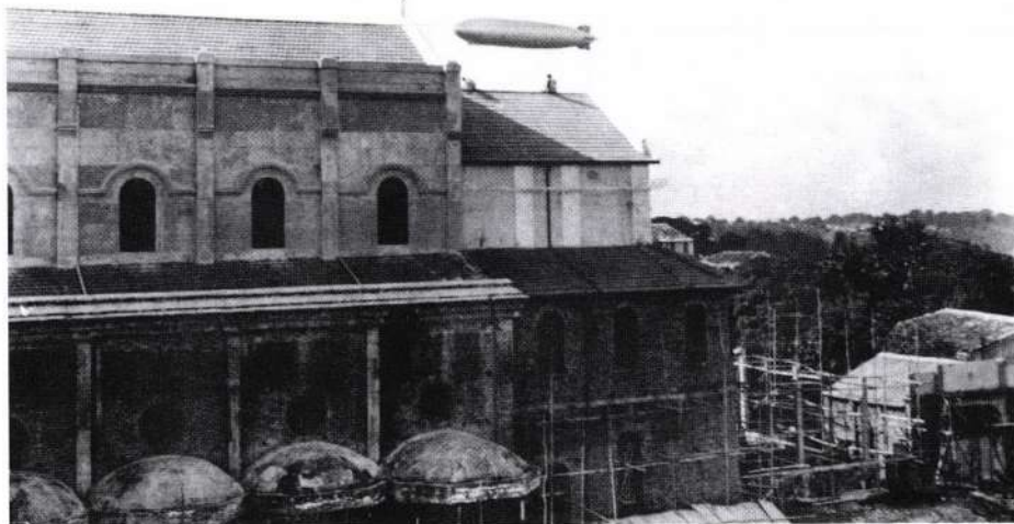
Em 1934, enquanto se ultimam os trabalhos da cobertura o dirigível alemão faz evoluções sobre o bairro de Nazaré, parecendo saudar os operários. AFR.
